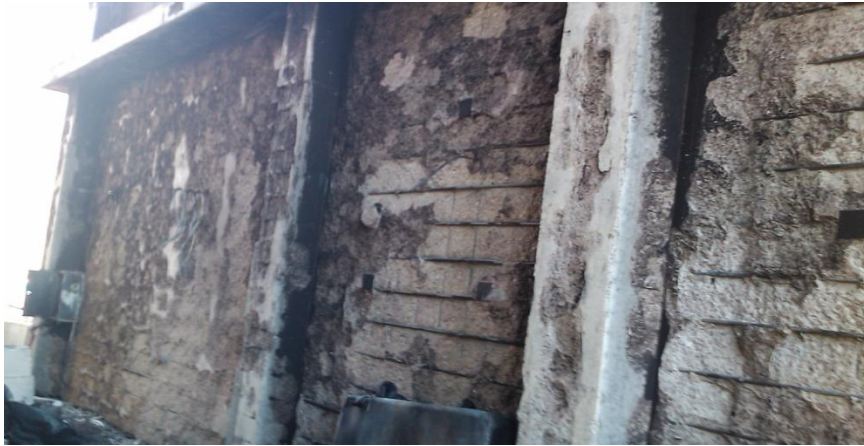
Рис. 4. Утрата защитного слоя бетона. Оголенная арматура
